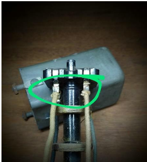
Figura 7: A decapagem incorreta e o acabamento deficiente no fio Litz, na época de fabricação do transformador, podem implicar possíveis defeitos no funcionamento do circuito, por maus contatos. Na soldagem todas as pontas dos fios Litz devem ficar eletricamente unidas ao terminal, para que não ocorra diminuição do fator de qualidade Q do indutor, entre outros problemas
